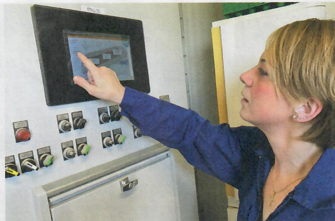
Hannelore Reifinger kontrolliert im Technikraum, der gleichzeitig als Hygieneschleuse dient, das Stall-Innenklima.
